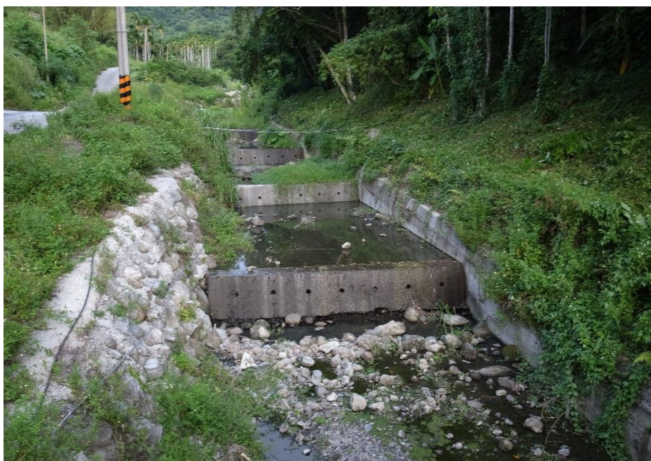
階梯狀的橫向構造物，使溪流生物棲地破碎化。
